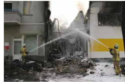
NACH DER DURCHZÜNDUNG An dieser Stelle fraß sich der Brand ins Gebäude
